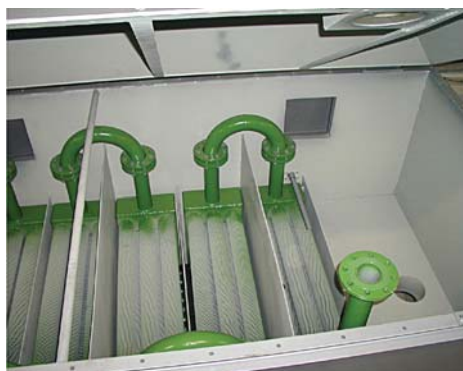
Рис. 17. Секции охлаждения с подводом охлаждающей воды
